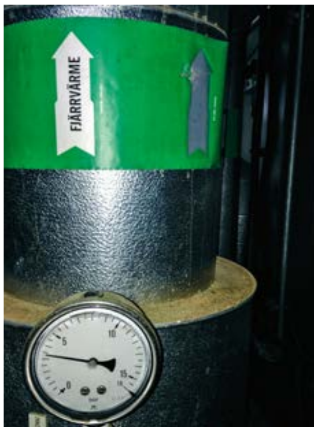
Fjärrvärmeanläggning utanför Helsingborg som OX2 förvärvade 2013.
