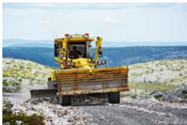
Byggnation på Glötesvålen, Härjedalens kommun. Längst upp till vänster: Johan Höök (byggprojektledare), Andrea Westling (miljökoordinator) och Jan Olof Dahlin (projektledare).
